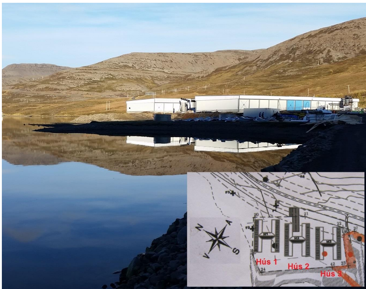
Mynd 4-1 Seiðaeldisstöð fyrirtækisins Arctic Smolt ehf. í byggingu í Tálknafirði. Seiðastöðin samanstendur af þremur húsum sem hvert um sig er 3.000 m 2 og kerjarými innahús verður samtals 8.400 m 3 . Lokið er að mestu byggingu á einu kerjahúsi (hús 1) og annað hús er langt komið (hús 3). Myndin sýnir fyrsta húsið sem þegar er komið í notkun og Hús 3 er að hluta komið í notkun. Innföld mynd sýnir staðsetningu eldisstöðvarinnar, neðan þjóðvegur í botni Tálknafjarðar.
